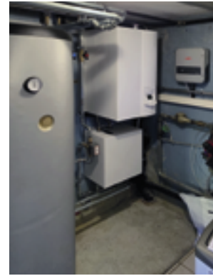
PAC air/eau Atlantic Excellia + Centrale solaire photovoltaïque Vue de l'unité intérieure et de son chauffe-eau, ainsi que du Fronius OhmPilot (l'électricité excédentaire produite par la centrale solaire est utilisée pour chauffer l'eau sanitaire).
