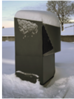
PAC air/eau Dimplex Remplacement d'une chaudière à mazout. La distribution hydraulique a pu être réutilisée.
