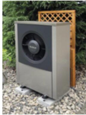
Pompe à chaleur Buderus Logatherm WLW196i.2-8 AR E. Remplacement de la chaudière à mazout. La distribution hydraulique au sol a pu être réutilisée.
